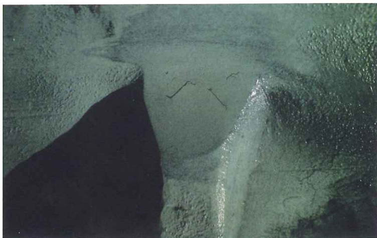
Bild 2: Risse im Eckanker
