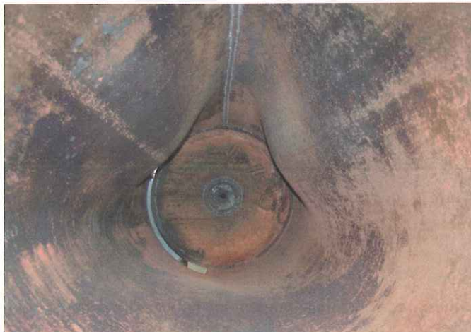
Bild 3: Überhitztes Flammrohr infolge Kesselsteinbildung
