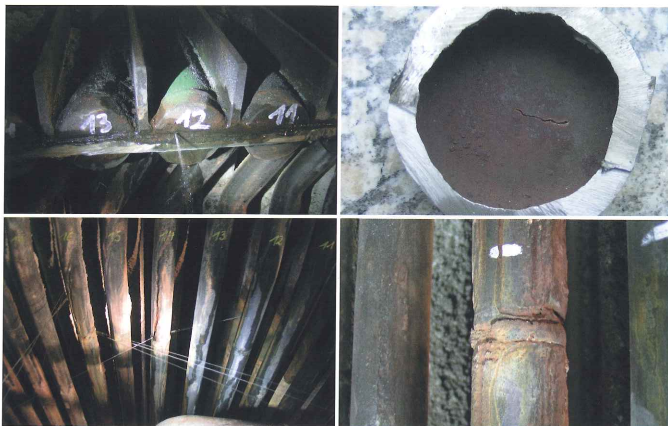
Bild 4: Säurekorrosion im Bereich der Taupunktunterschreitung am Economizer
