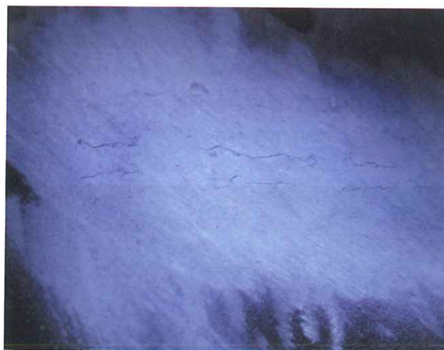
Bild 1: Rissverlauf in den Grundwerkstoff eines herausgetrennten Eckankers an der Verbindung Eckanker und Mantel
